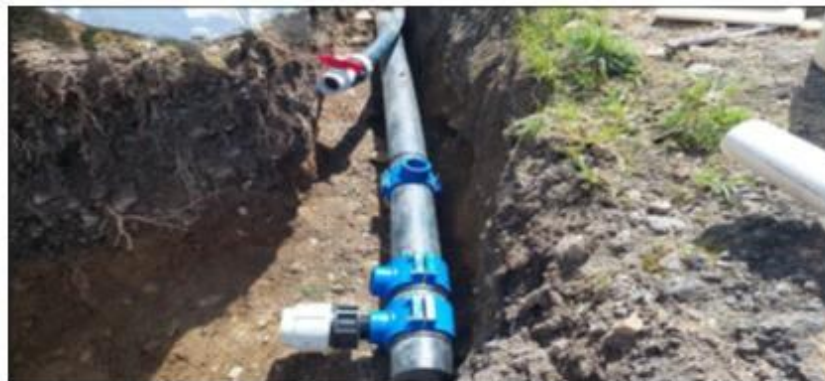
Imagen 3. Tubería de distribución en polietileno
