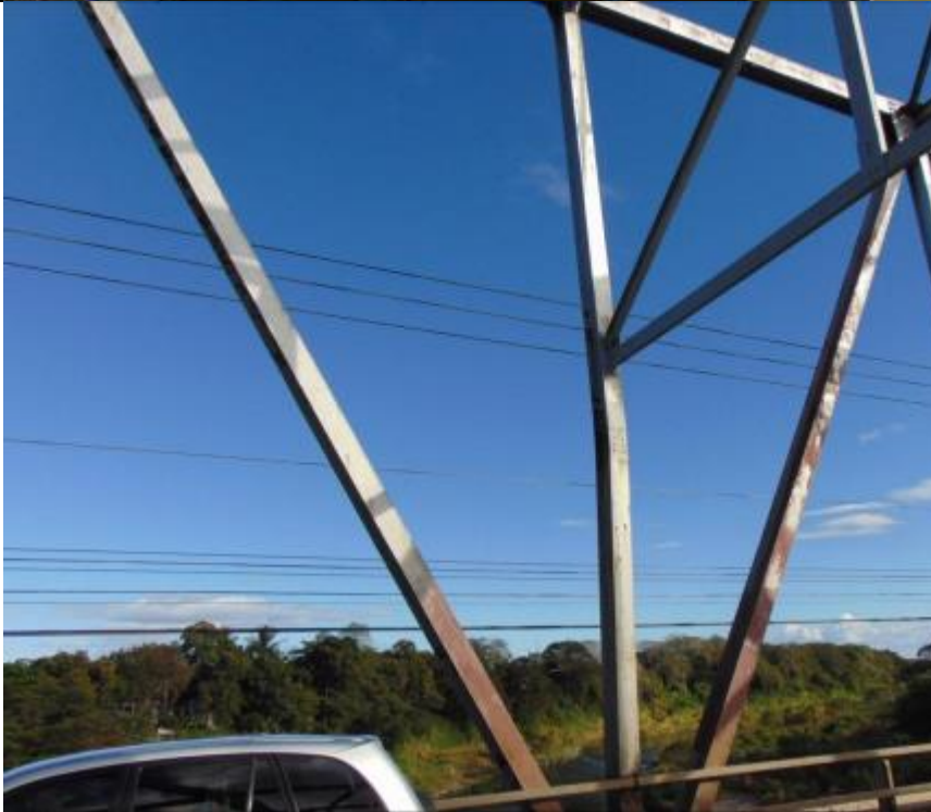
Deformación en cercha, viga principal, 2023.
