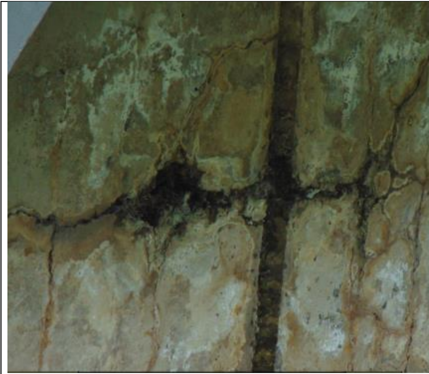
Agrietamiento en dos direcciones y descascamiento del concretoeflorescencias en losa, Losa, 2023.
